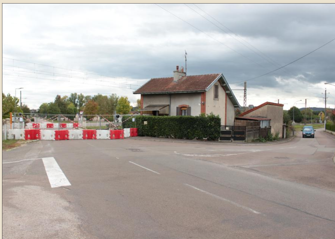
M. D. ■ Le passage à niveau, au cœur du village, est complètement fermé. Photo M. D.
